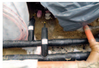
Hier kommen die Hausanschlüsse.
